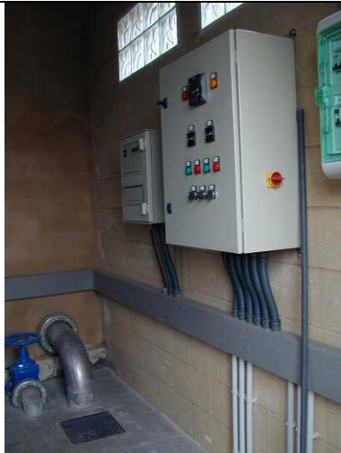
Quadres de comandament. Al fons es pot veure el sobreixidor i la descàrrega
