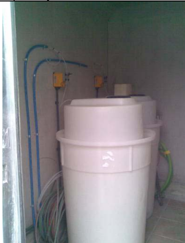
Caseta 3: Sistema de cloració amb HClO per als dipòsit d'aigua tractada
