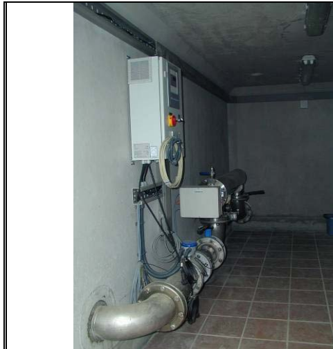
Caseta 1: Sistema de desinfecció per UV
