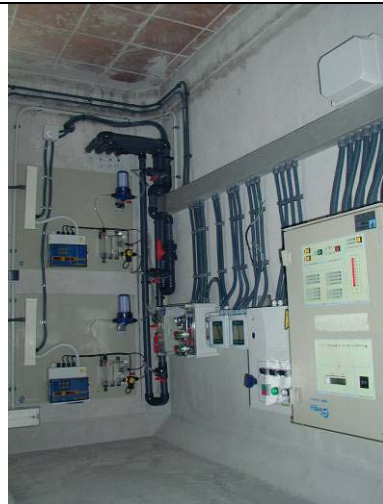
Caseta 2: Quadres elèctrics, telecontrol i analitzadors de clor en continu
