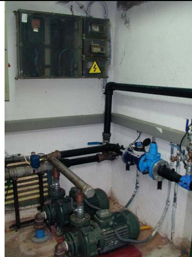
Quadres elèctrics i bombes horitzontals
