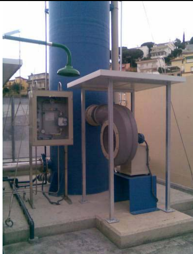
Difusor per a injecció de reactiu a la torre de neteja
