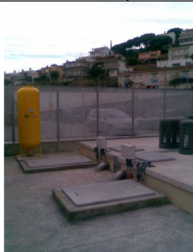
Dipòsit d'aigua tractada amb arqueta per a grups d'impulsió
