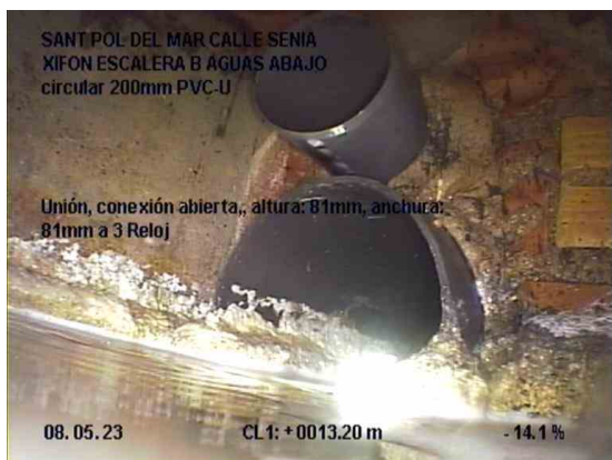
5, 00:07:48, 13.20m Unión, conexión abierta,, altura: 81mm, anchura: 81mm a 3 Reloj / ACOMETIDA ESCALERA BLOQUE C
