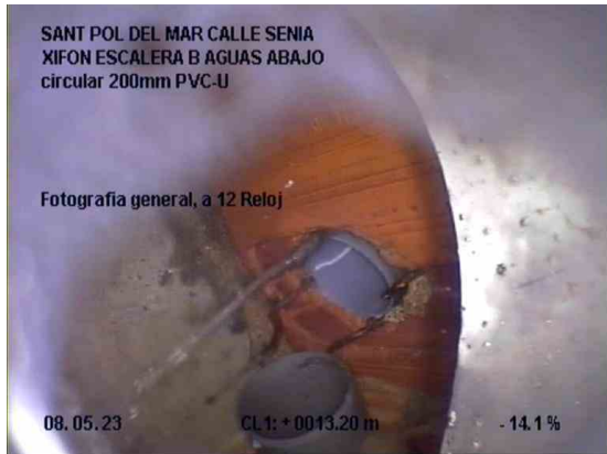
3, 00:05:47, 13.20m Fotografía general, a 12 Reloj / REJA DE ENTRADA PISCINA
