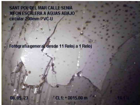
3, 00:04:16, 15.00m Fotografía general, desde 11 Reloj a 1 Reloj / ROTURA
