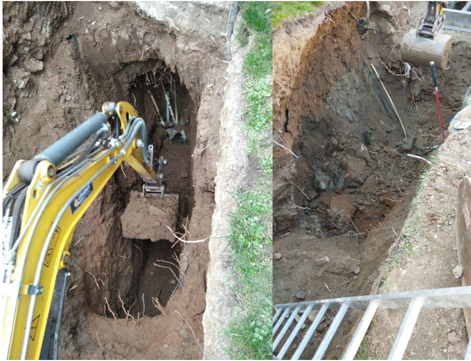
Figura 3: Talús molt inestable i impossibilitat d'obrir més l'excavació per la gran ocupació de tot el jardí i la proximitat amb la piscina.
