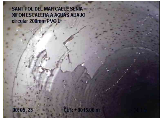
4, 00:04:16, 15.00m Fotografía general, desde 11 Reloj a 1 Reloj / ROTURA
