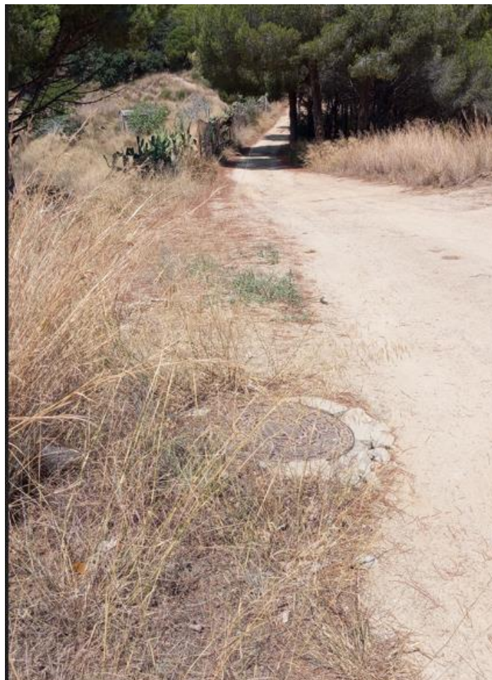
Figura 3 i 4. Imatges de la localització de l'arqueta amb vàlvula reguladora amb control i monitoratge IoT, del C. Herois Fragata Numància.
